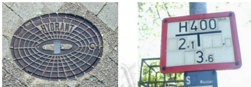
Abdeckung Unterflurhydrant und Hinweisschild
